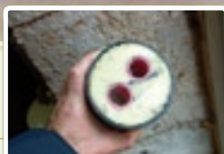
Tuyaux pré-isolés du réseau de chaleur
