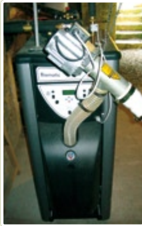
Chaudière et son alimentation automatique
