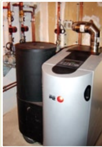
Chaudière et son mini silo (noir)
