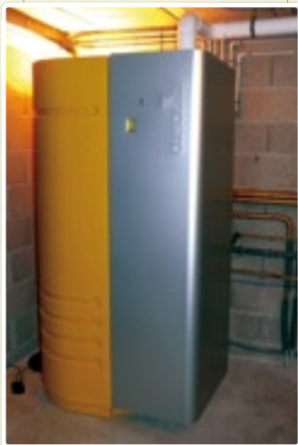
Bloc ballon - régulation - chaudière
