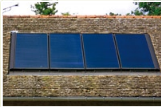
Capteurs intégrés en toiture
