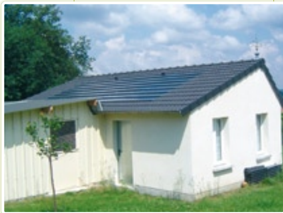
Panneaux photovoltaïques remplaçant les tuiles
