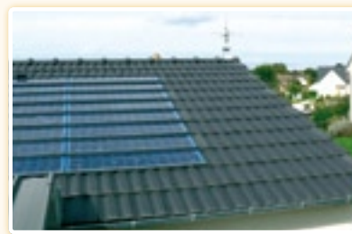
Guérigny (58) Modules intégrés en toiture
